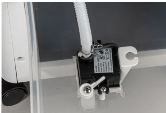
Rys. 5. Pompa wodna w zbiorniku na wodę.
